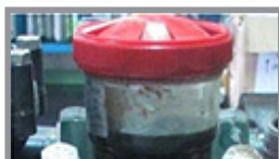
Uleiul în funcțiune Pompă
