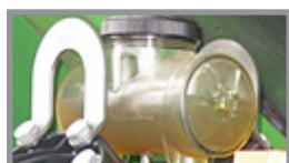
Ulei în noua pompă
