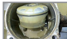
Ulei după diafragmă Ruptură
